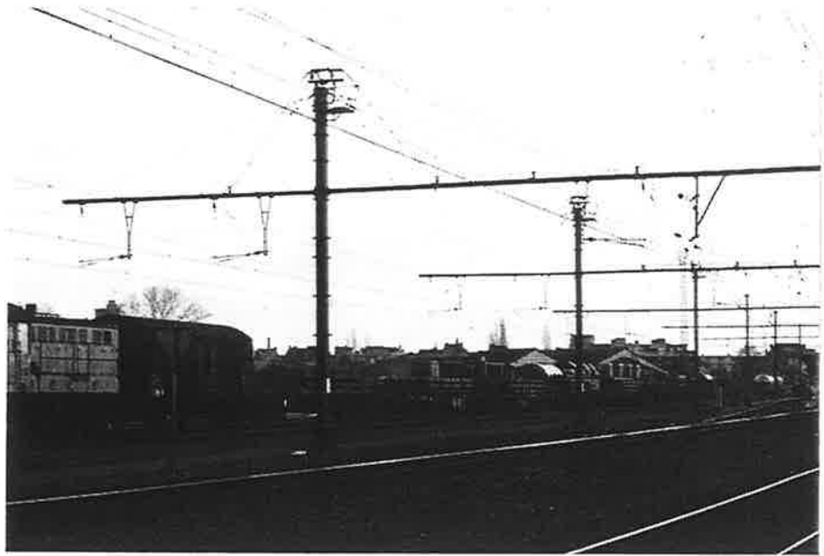
In Lier zien we duidelijk het "aftappen" van de spanning vanuit het hoofdspoor naar de beide zijsporen links, via de T-schakelaar bovenop de bovenleidingspaal. Links onderaan prijkt de gele 8516 in proefschildering. 26 april 1985.
